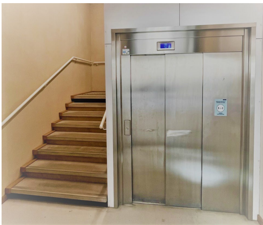
Ascenseur accessible PMR ( Rez-de-chaussée ) Accès au 1 er étage (Tout public)
