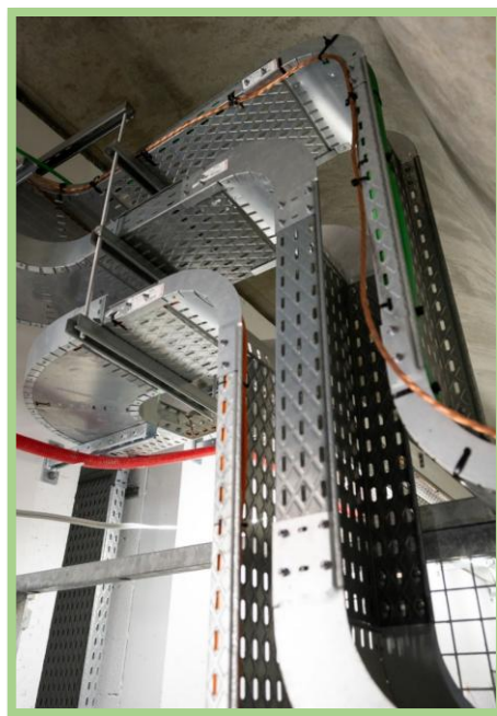
Chemin de câbles de la station Diadora ©Fabien FERRER – février 2026
