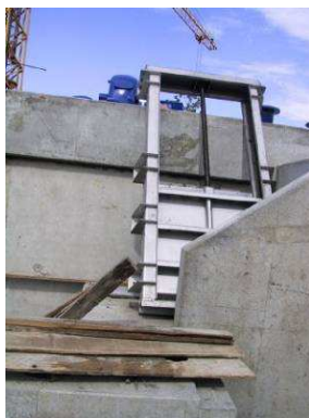
Une vanne, élément participant au dispositif de protection contre les crues
