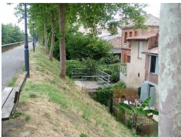
Bâti très proches de la digue sur le long de l'Avenue de Muret
