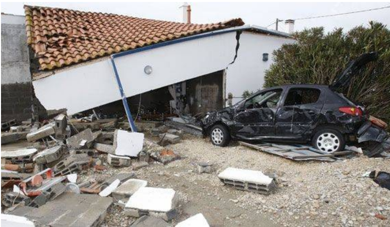
Construction démolie suite à rupture de digues (tempête Xynthia en février 2010)
