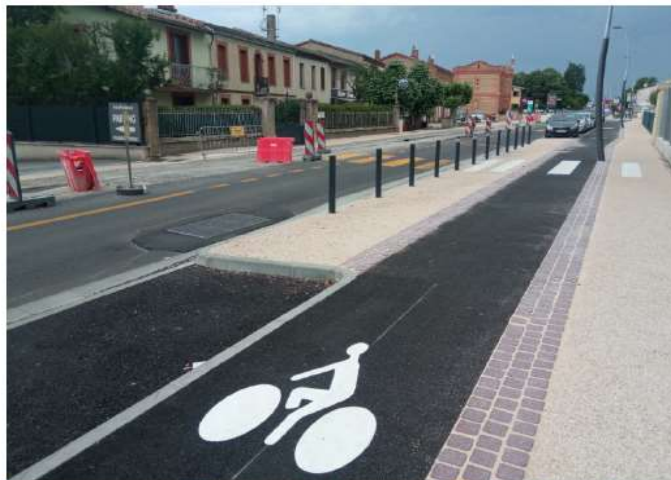
Projet de requalification du Cœur de Ville de Saint-Orens (M2) actuellement en travaux, insertion de 2 pistes cyclables monodirectionnelles sur l'ensemble du périmètre
