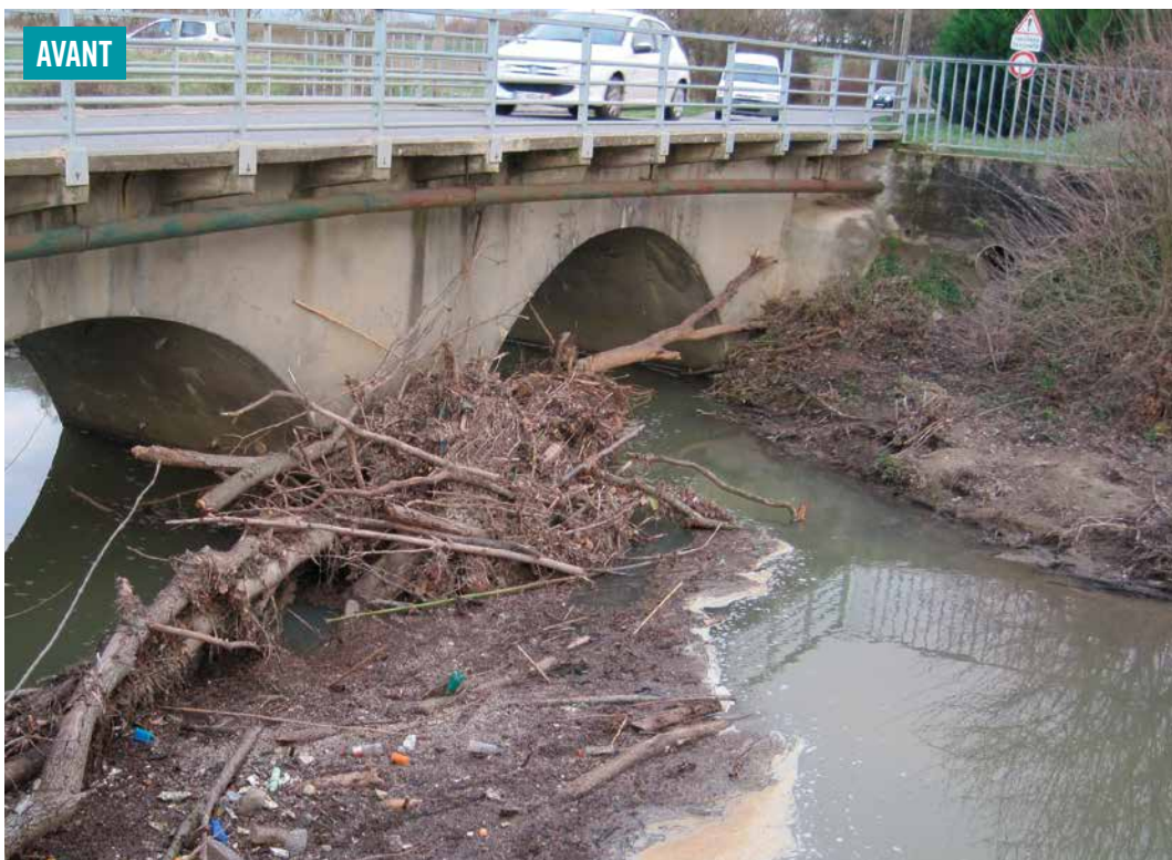
Situation d'urgence nécessitant l'intervention exceptionnelle de la collectivité sur une partie de cours d'eau relevant du domaine privé.
