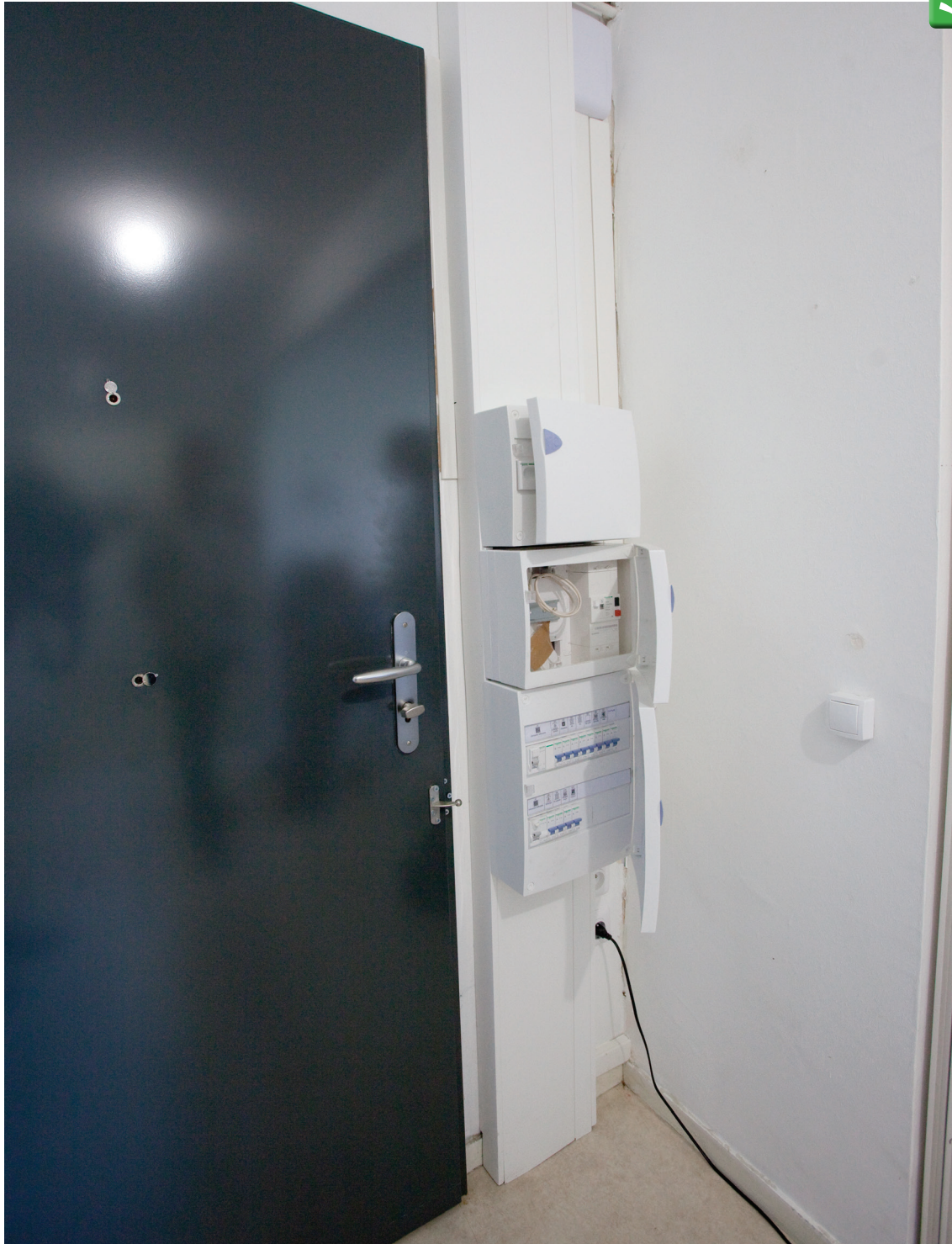
Exemple d'un compteur électrique correctement positionné
